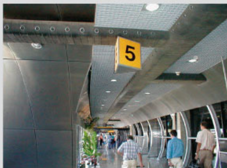
Difusor de Plástico AIRJET instalado
